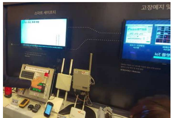
롯데제과 부산공장에 구축완료 된 고장 예지/ 화재예방 솔루션
